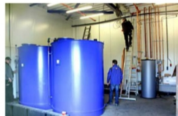
Installatietechniek is van groot belang bij VivoChem
