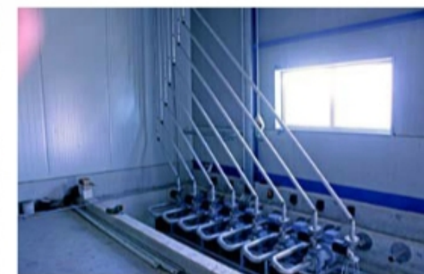
Elke chemische vloeistof heeft eigen pomp- en leidingstelsel
